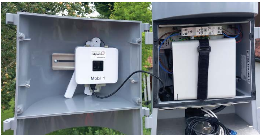
Geöffnetes EPV4-Anschlussgehäuse mit Managed Switch und Blitzschutz. Das LFP-Akku-System befindet sich im oberen Gehäuseteil. Zusätzlich verbaute Kundengeräte: Cloud Key, LTE-Router
